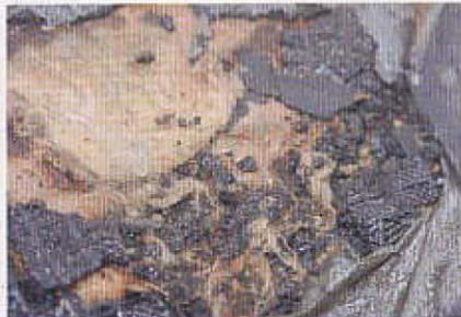
Das Problem: Auch Dämmung altert. Die Bitumenschicht der Oberfläche bröckelt, die Deckfolie reißt. Nur das Jutfelz ist noch okay
