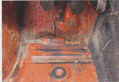
Bitumen als Rostfalle: Bei Restaurierungen sollte der alte Lärmschutz auf jeden Fall genau unter die Lupe genommen werden...
